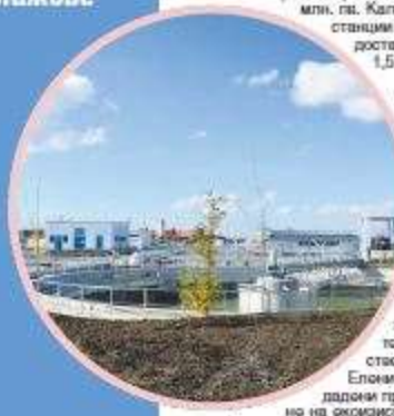
Пречиствателната станция в Русалка е най-голямата по Българското Черноморие. Снимка: Елена Фотала
